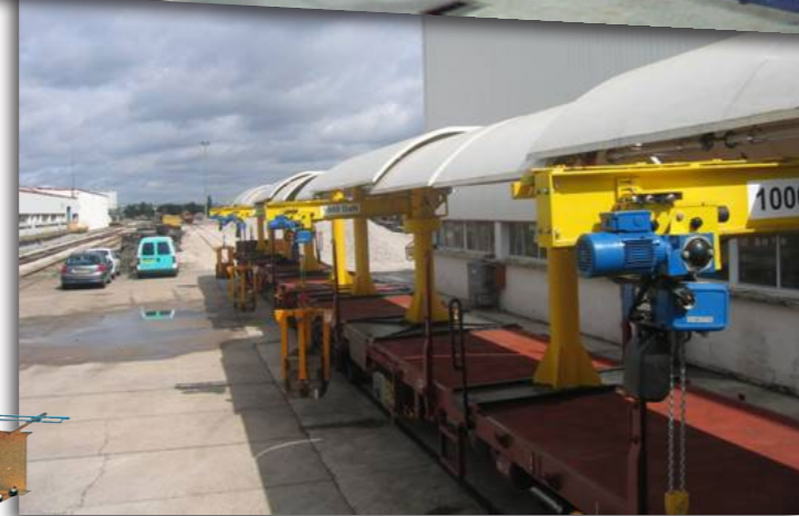
Potences spéciales pour maintenance des rails du métro Jib-cranes for rail tracks maintenance (subway)
